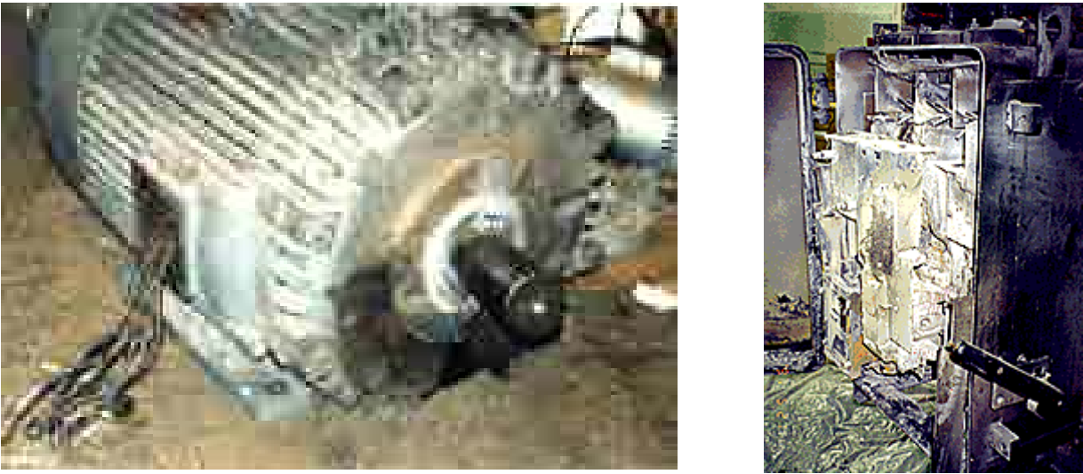
Fig. 4.6c. Daños en equipos eléctricos ocasionados por fuertes corrientes de falla.
